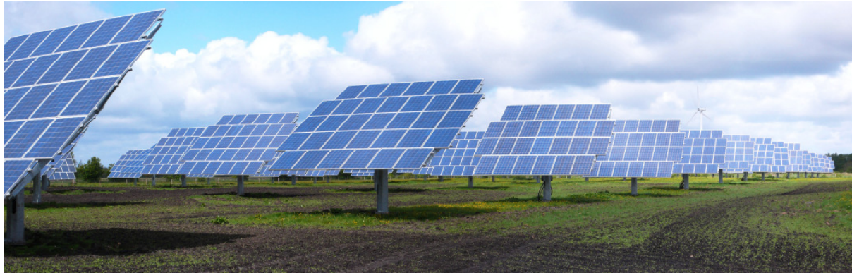
Freiflächenanlage in Sprakebüll mit zweiachsiger Nachführung (Nordfriesland/Schleswig-Holstein)
